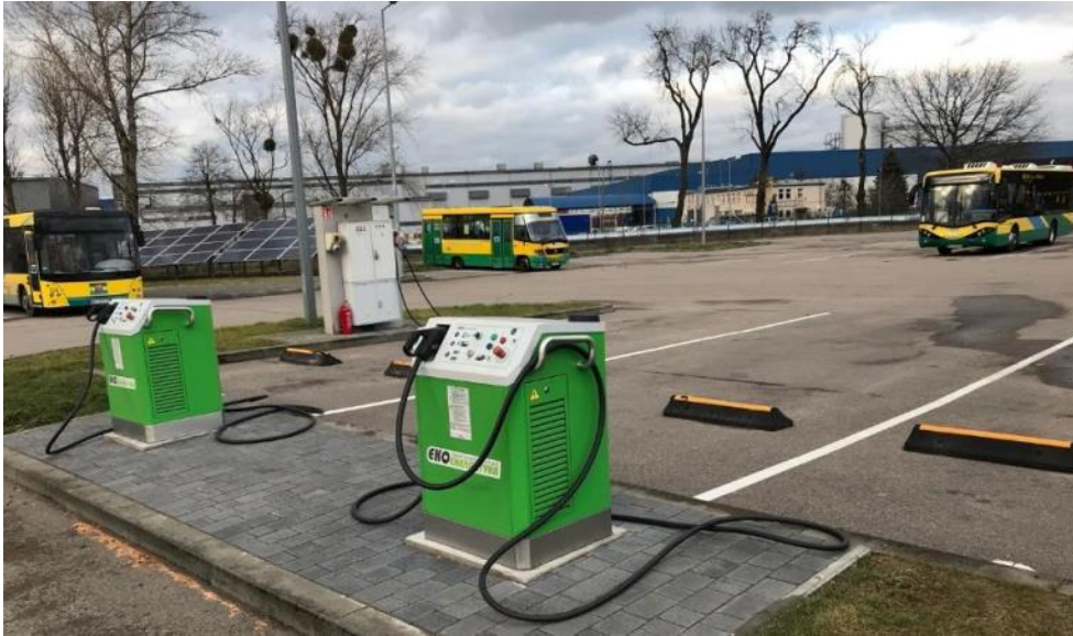
Rysunek 78. Widok na punkty ładowania na terenie zajezdni autobusowej MZK Ostrołęka
