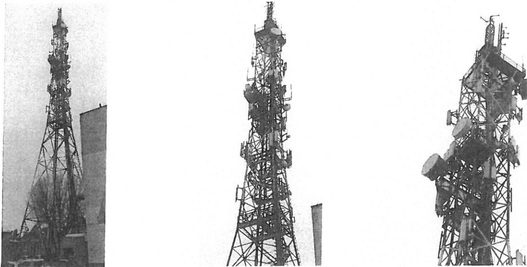
Widok obiektu wraz z zainstalowanym zespołem antenowym
