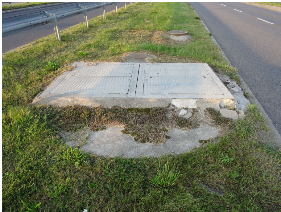
Fot.7. Studzienki w pasie rozdziału - uszkodzona opaska betonowa, wystające ponad teren pokrywy studzienek
