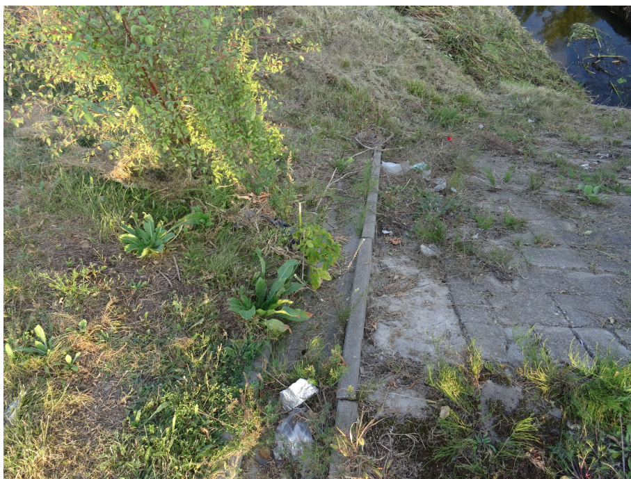
Fot.2. Widok ścieku skarpowego i umocnienia skarp od strony wlotu- zanieczyszczenia i roślinność
