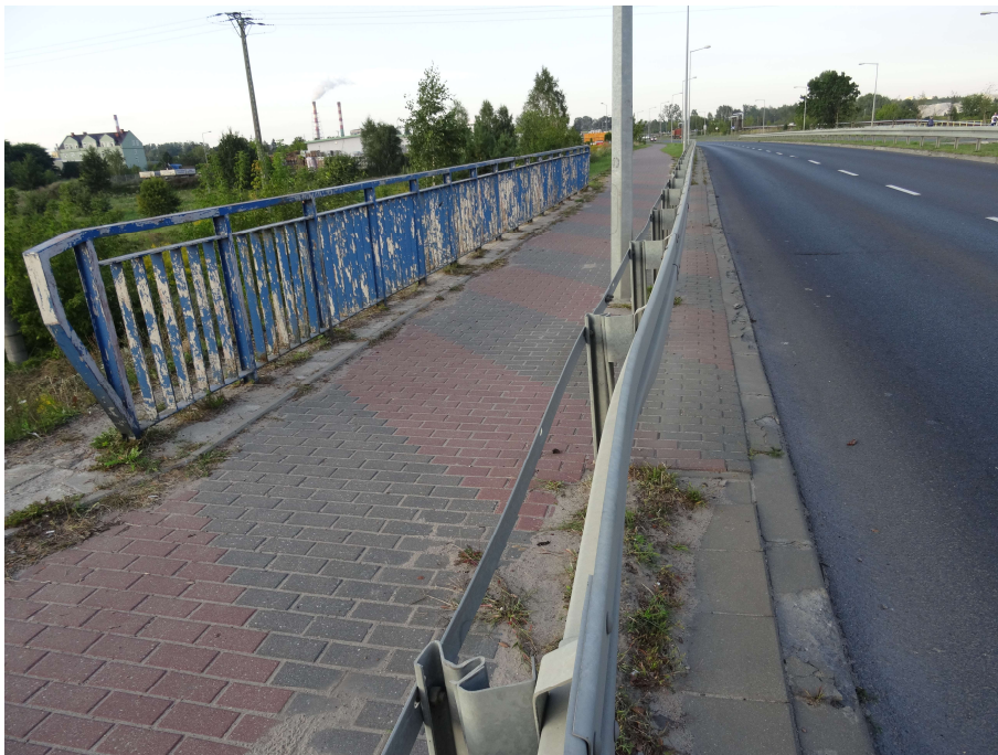
Fot.14. Jezdnia lewa i chodnik lewy (od strony wylotu) -zanieczyszczenia i roślinność wzdłuż balustrad i barier, uszkodzenia barier
