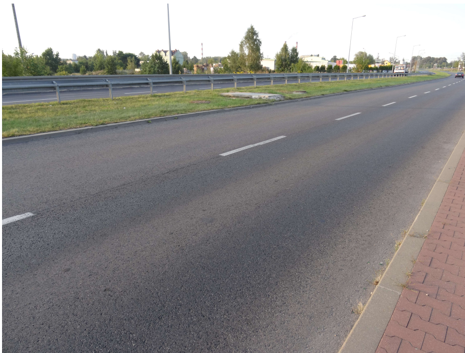
Fot.6. Jezdnia prawa (od strony wlotu) – zanieczyszczenia wzdłuż krawężników
