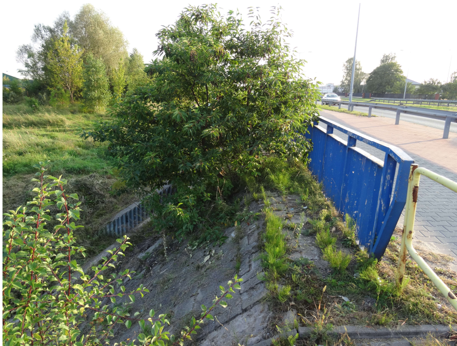
Fot.3. Umocnienie skarp od strony wlotu-zanieczyszczenia i roślinność na umocnieniu skarp, korozja balustrad
