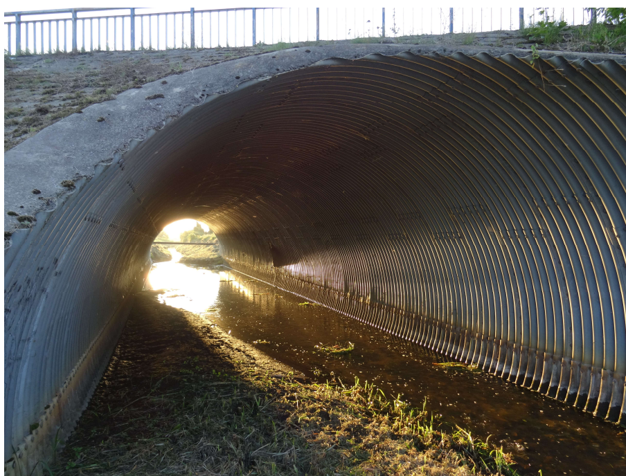
Fot.20. Wnętrze przepustu (od strony wlotu) - zanieczyszczenia do usunięcia
