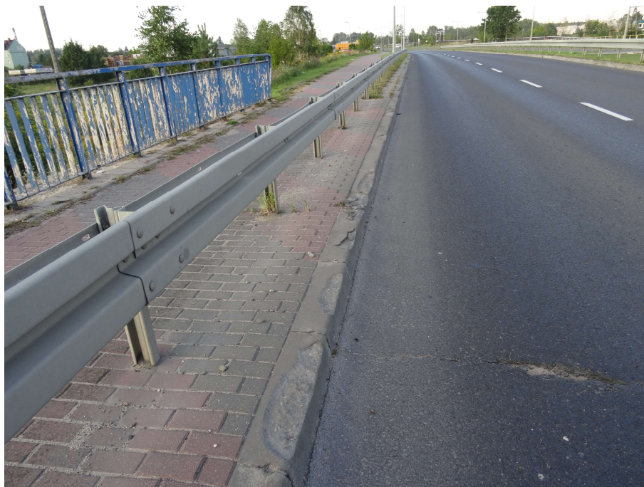
Fot.15. Korozja krawężnika przy chodniku - jezdnia lewa (od strony wylotu)
