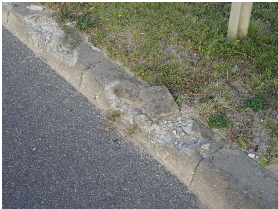
Fot.9. Korozja krawężnika przy pasie rozdziału - jezdnia lewa
