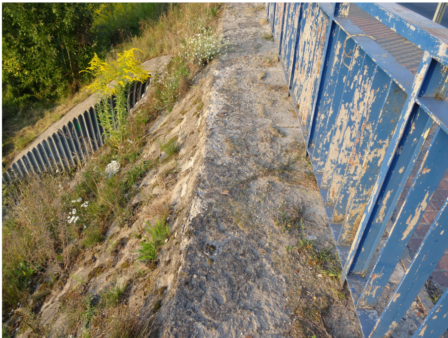
Fot.12. Jezdnia lewa i chodnik lewy (od strony wylotu) -zanieczyszczenia i roślinność wzdłuż balustrad i na umocnieniu skarp, korozyja balustrad i betonu umocnienia
