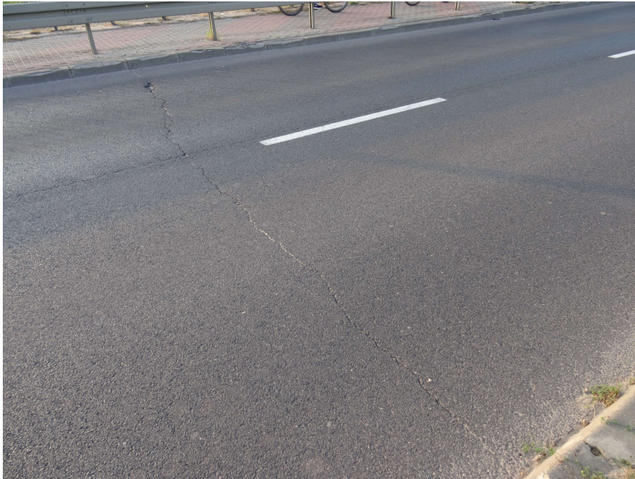
Fot.11. Jezdnia lewa – rysa w nawierzchni
