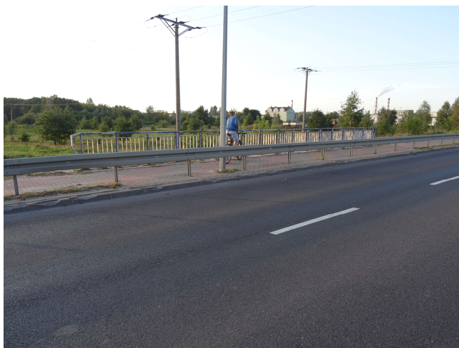
Fot.10. Jezdnia lewa i chodnik lewy (od strony wylotu) - korozja krawężnika
