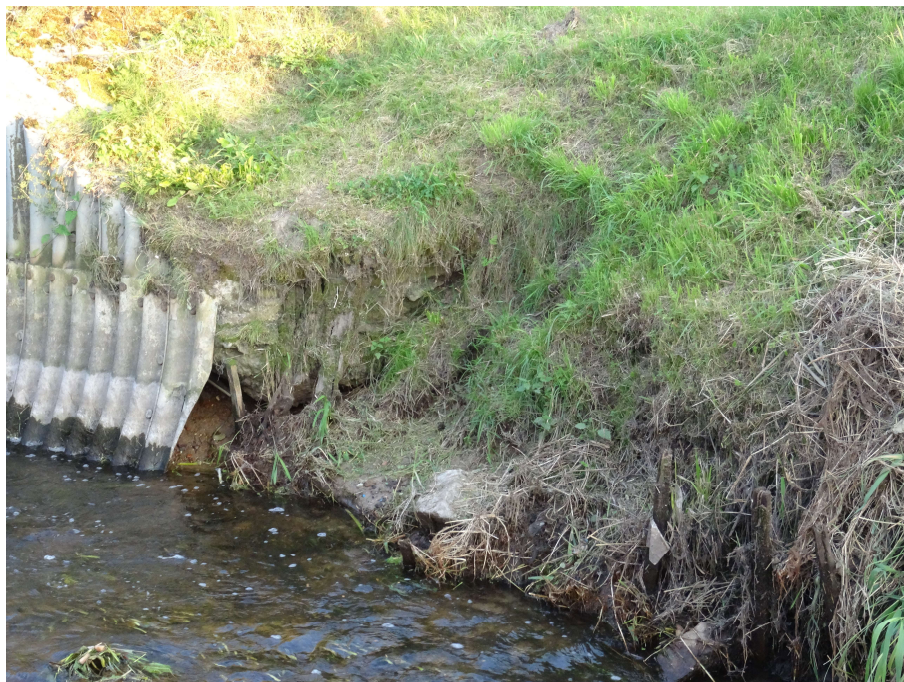
Fot.19. Wylot przepustu na lewym brzegu - rozmycie brzegu i ubytki gruntu
