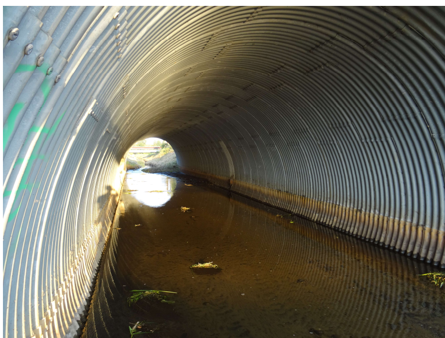
Fot.18. Wnętrze przepustu od strony wylotu- zanieczyszczenia do usunięcia
