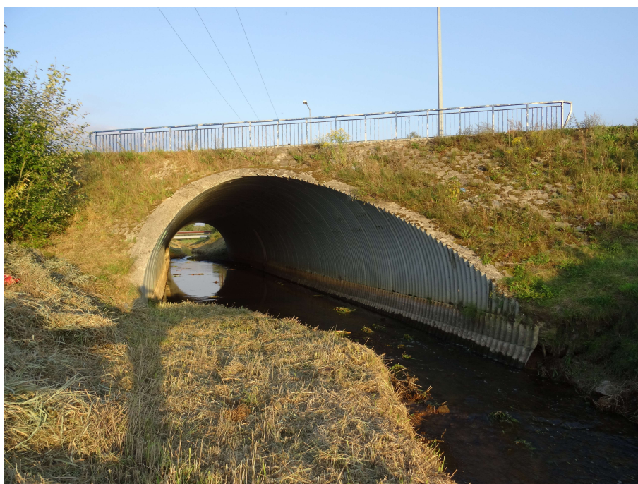
Fot.16. Widok przepustu od strony wylotu - zanieczyszczenia i roślinność na umocnieniu skarp, rozmycie brzegu i ubytki gruntu na wylocie
