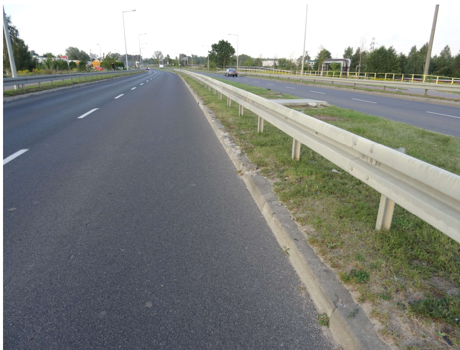
Fot.8. Bariera w pasie rozdziału i jezdnia lewa (od strony wylotu) – zanieczyszczenia wzdłuż krawężników
