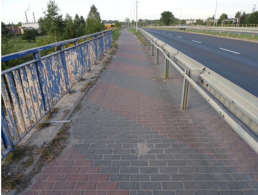
Fot.13. Jezdnia lewa i chodnik lewy (od strony wylotu) -zanieczyszczenia i roślinność wzdłuż balustrad, korozja balustrad i betonu umocnienia
