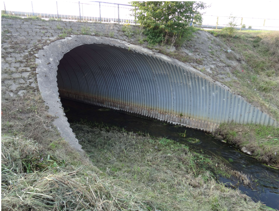
Fot.1. Widok przepustu od strony wlotu - zanieczyszczenia i roślinność na umocnieniu skarp
