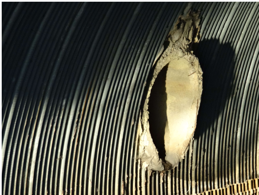
Fot.17. Wnętrze przepustu –rurowy wylot kanalizacji wymagający przedłużenia i uszczelnienia
