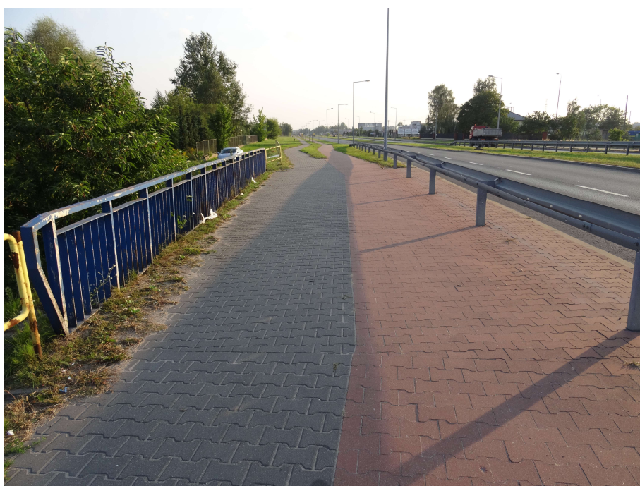
Fot.4. Widok chodnika i ścieżki rowerowej strona prawa (od strony wlotu)-zanieczyszczenia i roślinność wzdłuż balustrad, korozja balustrad
