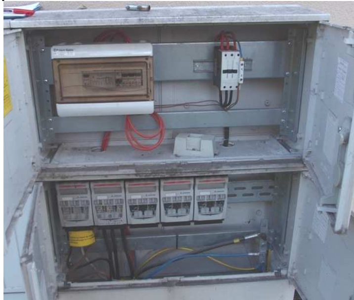
istn. szafka SSO2 – widok wnętrza
