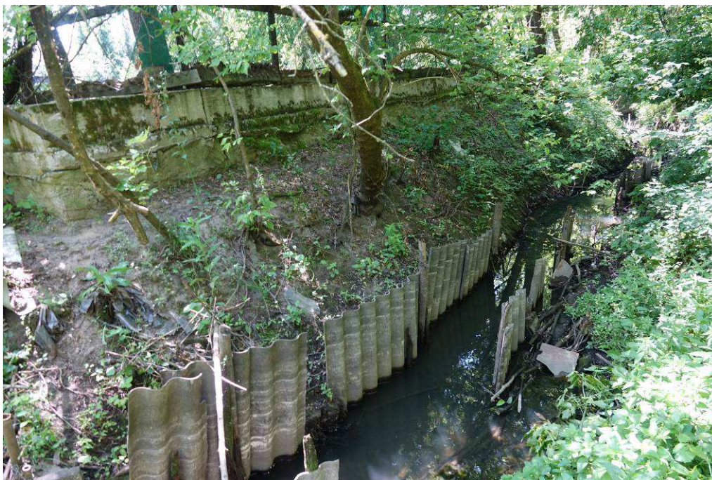
Fot. 7 Kanał dopływowy. Widoczne zabezpieczenia skarp przed osuwaniem zlokalizowane powyżej umocnień z płytek betonowych. Użyty materiał i sposób wykonania wskazują, że było to działanie nieprofesjonalne, wykonane metodą "gospodarczą".
