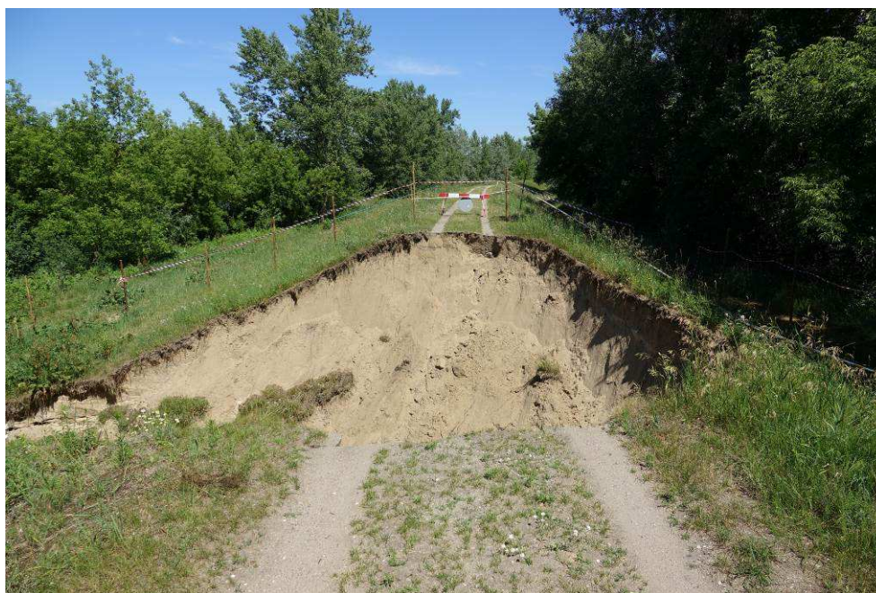
Fot. 1 Wał przeciwpowodziowy. Widok na koronę wału (w górę rzeki) oraz powstałą wyrwę. Korpus wału nie posiada przesłony filtracyjnej.
