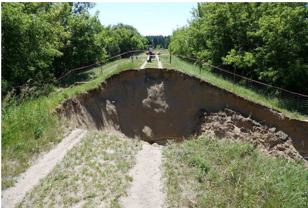
Fot. 2 Wał przeciwpowodziowy. Widok na koronę wału oraz powstałą wyrwę (w dół rzeki). Widoczna pozostałość ławeczki od strony zawala.
