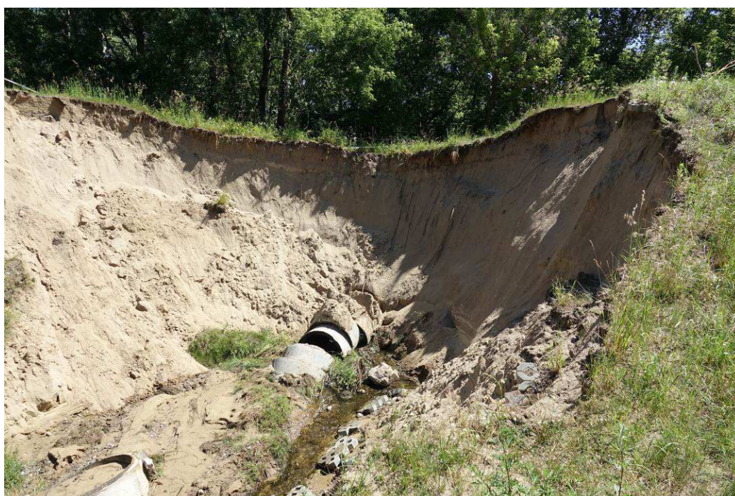
Fot. 4 Wał przeciwpowodziowy. Wyrwa powstała od strony wylotu z przepustu wałowego. Widoczne kręgi ze zniszczonego przewodu przepustu.
